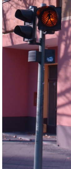
Abbildung 34: Hilfssignalgeber LSA 03055 Hohenzollerndamm/ Uhlandstraße Berlin
