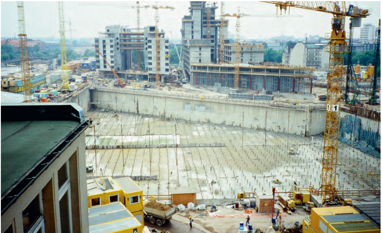
Abbildung 3 b Anschließend wird aus dem fertigen Trog das verbliebene Grundwasser gelenzt. Die Baugrubensohle wurde vorher noch mit 20 Meter langen Erdankern gegen Auftrieb (17 Meter Wassersäule!) gesichert. Foto: Alexander Limberg
