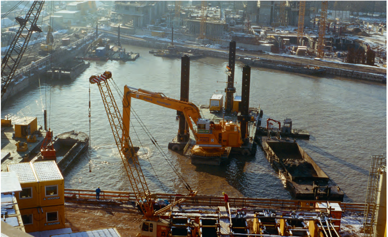
Abbildung 3 a Trogbaugrube am Potsdamer Platz mit Blick vom Weinhaus Huth: Nach Errichtung der Schlitzwand wird das Erdreich vom Ponton aus mit dem Bagger ausgehoben. Im entstandenen Grundwassersee wird mit Tauchern eine Unterwasserbetonsohle gegossen. Foto: Alexander Limberg
