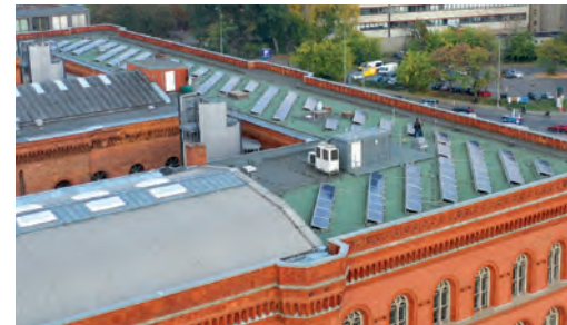
Photovoltaikanlage auf dem Dach des Rathauses Photovoltaic array on the roof of the town hall
